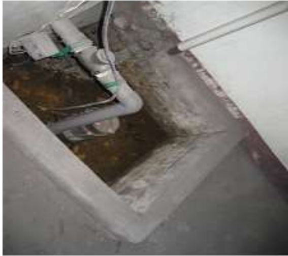
地下室儲水槽
