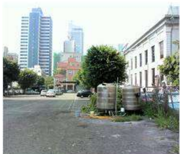
停車廠水塔無蓋
