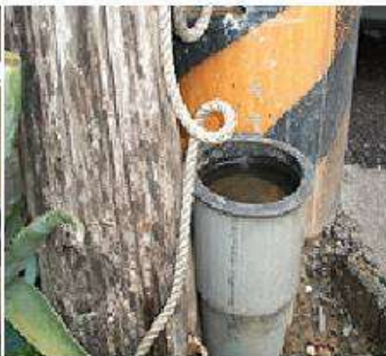
台電地下電纜引上管
