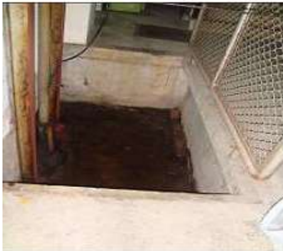
地下室之升降梯孔積水
