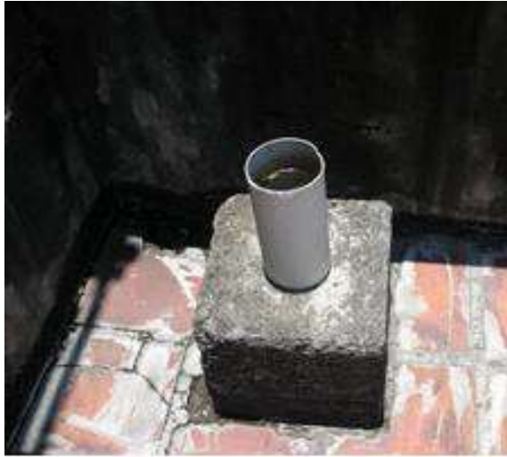
水泥樁上之水管
